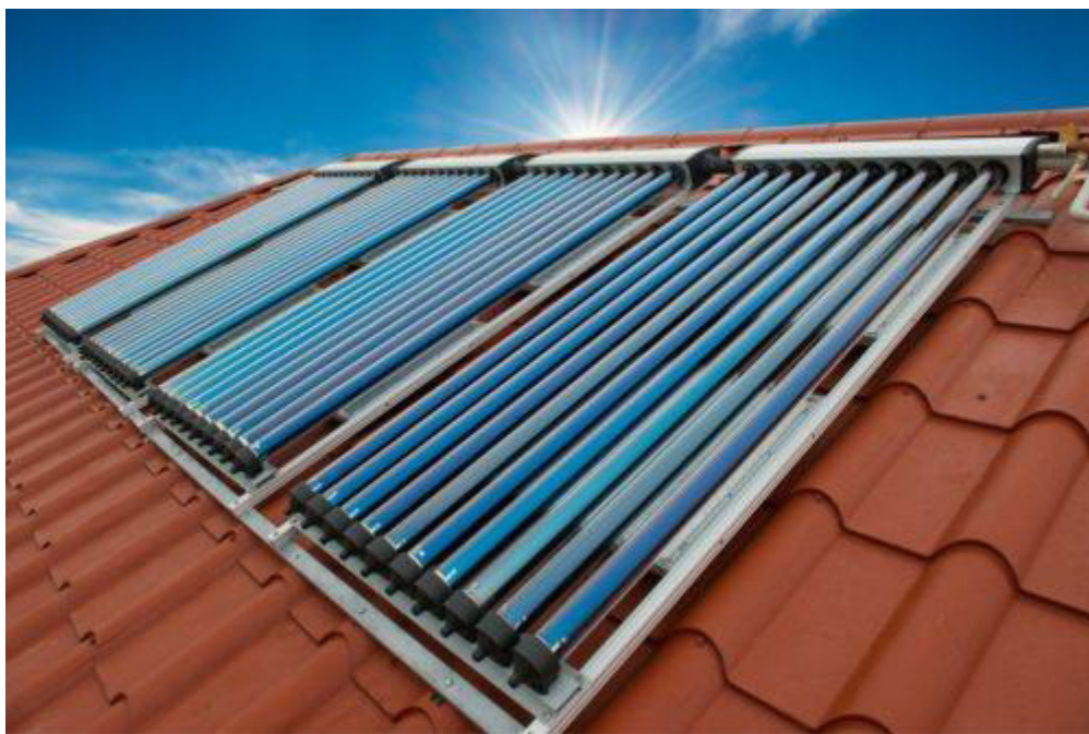
Figura 5- Impianto solare termico.
